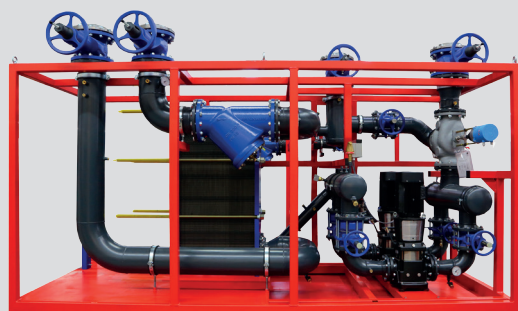
Rückkühleinheit Klinikum Bremen
