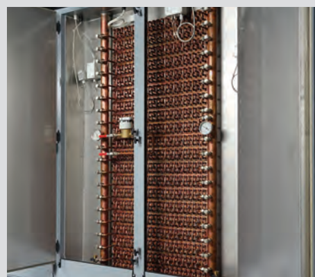
Außenluft GSWT®, Klinikum Großhadern
