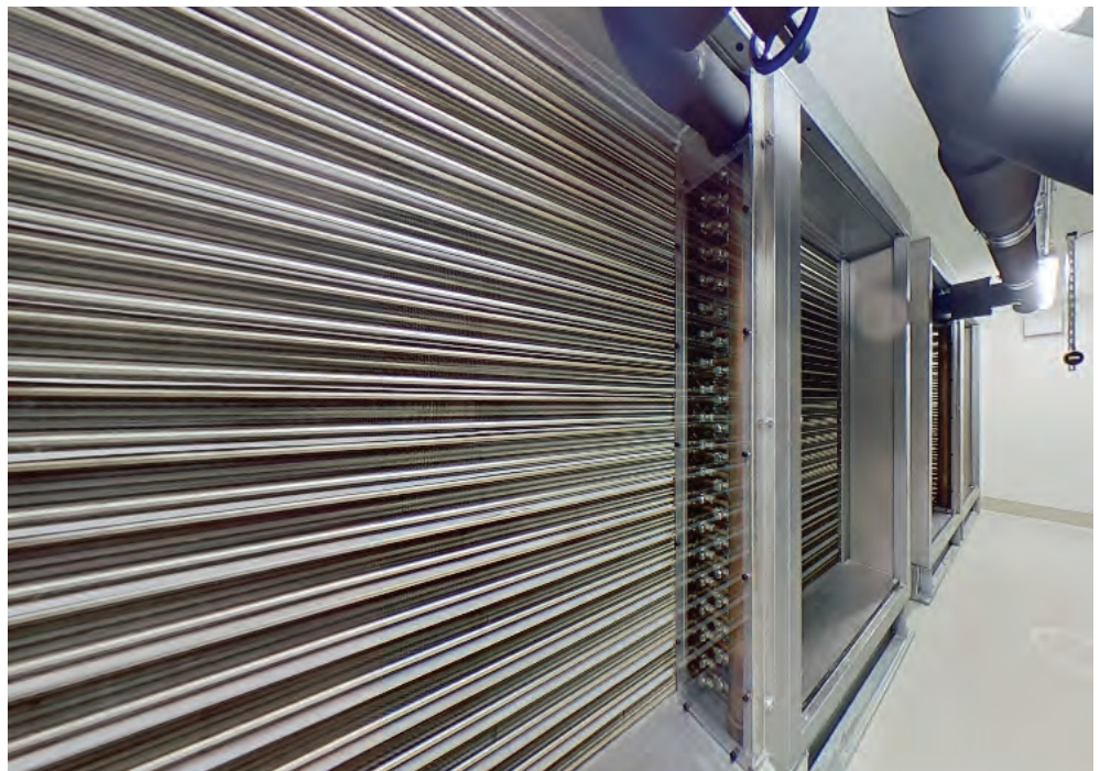
Extrem-Entfeuchtungskühler in der Nationalgalerie in Berlin.
