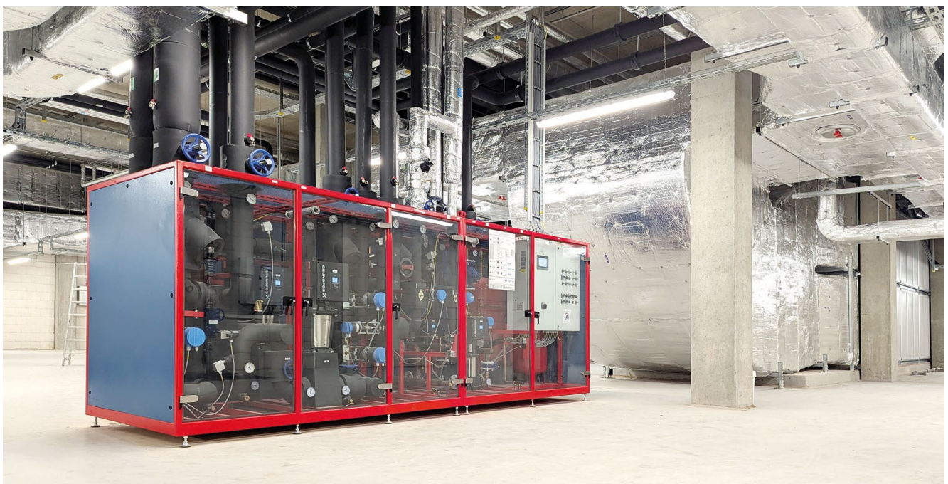
Die Pumpen-Armaturen-Baugruppe ist für das GSWT-Kreislaufverbundsystem von SEW die zentrale hydraulische Einheit.
