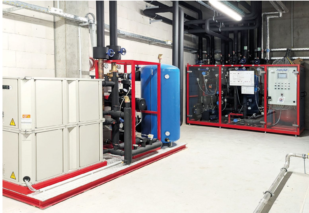
Kreislaufverbundsystem für hohe Energieeffizienz: Im Vordergrund die Nachkühler-Baugruppe mit Kältemaschine und Pufferspeicher, im Hintergrund die Pumpen-Armaturen-Baugruppe.
