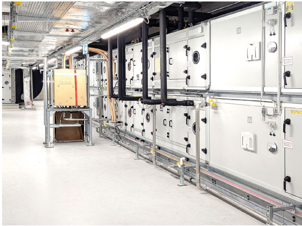
Im Klimakanal sind die Wärmetauscher Module montiert. Die isolierten, schwarzen Rohrleitungen des Kreislaufverbundsystems kommen von der Pumpen-Armaturen-Baugruppe und leiten auch dorthin zurück.
